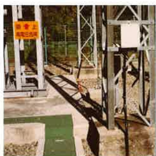
発電所・変電所
